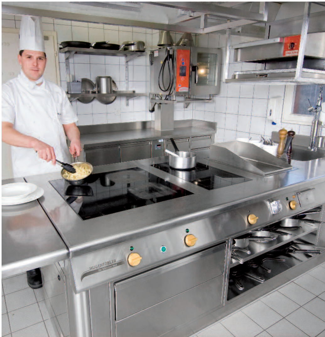
Pächter und Küchenchef Mirco Schumacher steht am neuen «Schweizer Herd» der Hugentobler AG mit Cerangrosskochfeld, Induktionskochfelder, Griddle-Platte und eingebauten Spülbecken. Im Herdunterbau integriert sind zwei Wärmeschubladen für je 60 Teller sowie eine offene Pfannenablage.
